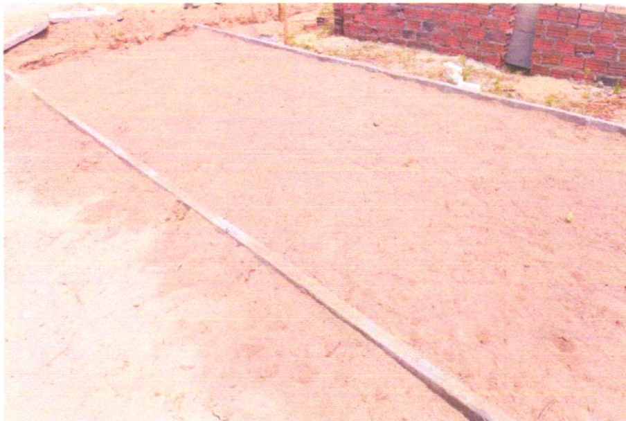
FOTO 03 - REATERRO MANUAL COM COMPACTAÇÃO MECANIZADA EM CAMADAS DE 0,20 M NO MÁXIMO, COM MATERIAL DA PRÓPRIA OBRA
