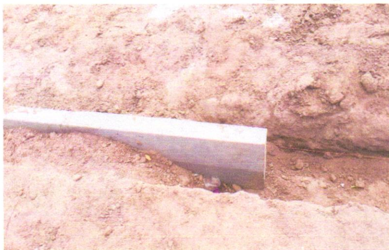
FOTO 06 – ASSENTAMENTO DE GUIA (MEIO-FIO) EM TRECHO CURVO, CONFECCIONADA EM CONCRETO PRÉ-FABRICADO, DIMENSÕES 100X15X13X20 CM (COMPRIMENTO X BASE INFERIOR X BASE SUPERIOR X ALTURA), PARA URBANIZAÇÃO INTERNA DE EMPREENDIMENTOS. AF_06/2016_P
