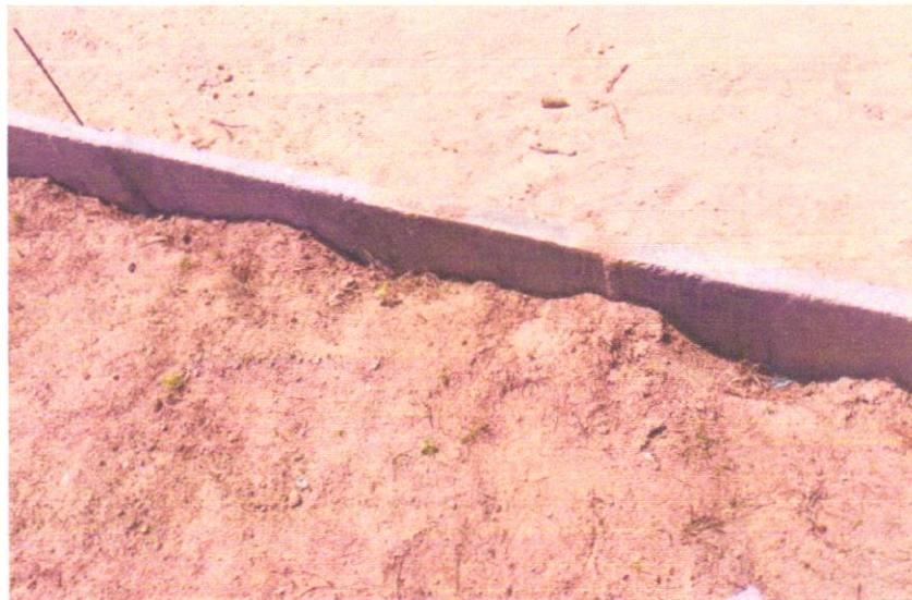
FOTO 05 – ASSENTAMENTO DE GUIA (MEIO-FIO) EM TRECHO RETO, CONFECCIONADA EM CONCRETO PRÉ-FABRICADO, DIMENSÕES 100X15X13X20 CM (COMPRIMENTO X BASE INFERIOR X BASE SUPERIOR X ALTURA), PARA URBANIZAÇÃO INTERNA DE EMPREENDIMENTOS. AF_06/2016_P
